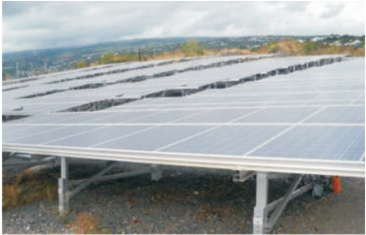
Figuur 1: Foto van 'n fotovoltaïese sonkragaanleg
