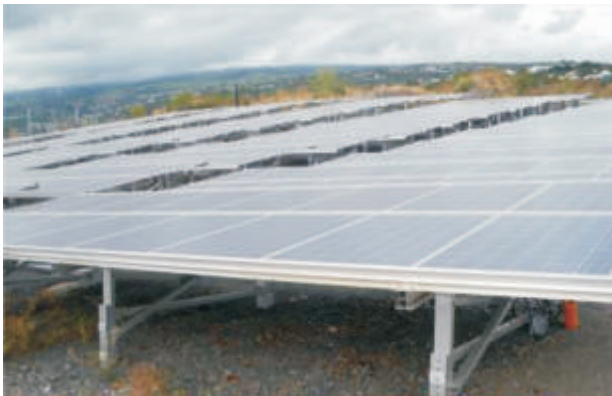
Figuur 1: Foto van 'n fotovoltaïese sonkragaanleg
