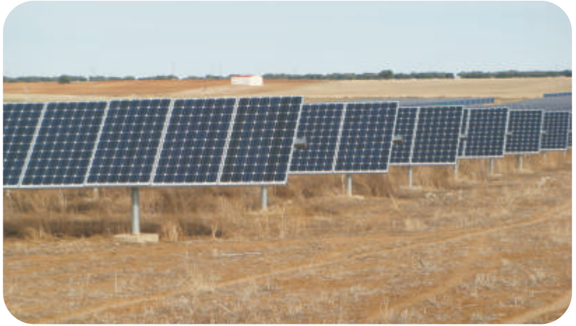
Foto van geïnstalleerde FV-sonkragtegnologie
